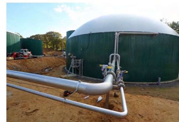
▲ Unité de méthanisation Liger à Locminé (56). Photo : François Destoc / Le Télégramme
